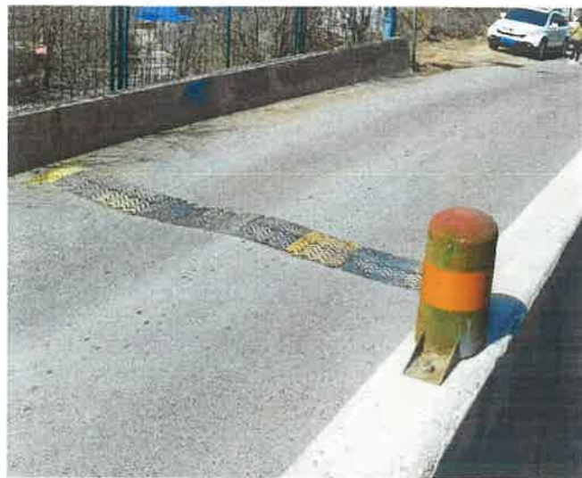
图 3 减速垄开裂变形
