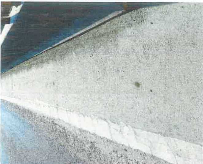
图 1 标线开裂严重
