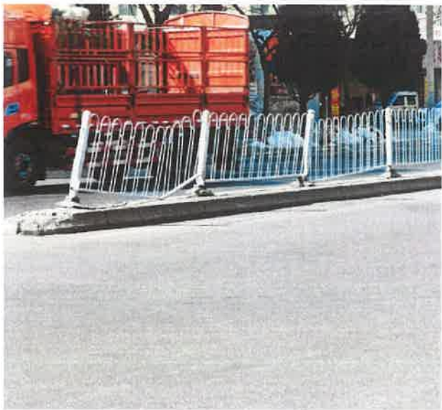
图 1 隔离栏杆变形
