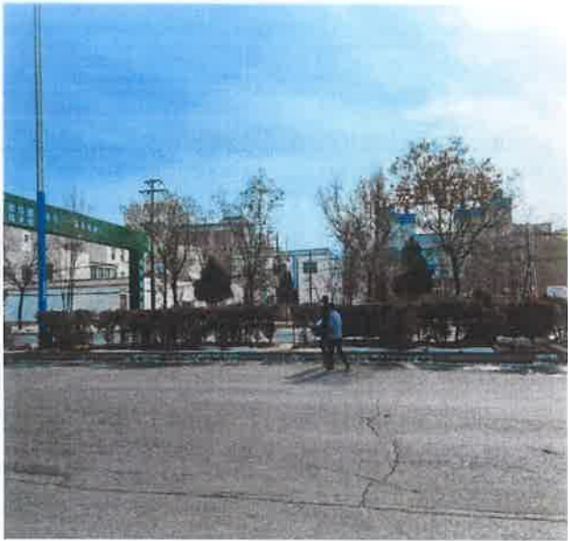
图 4 部分路段缺少隔离栏杆
